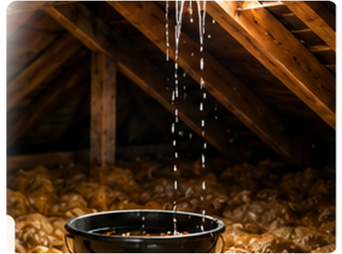
Infiltration active dans les combles : sécuriser la zone, protéger les biens, photographier les traces et contacter rapidement un professionnel.
